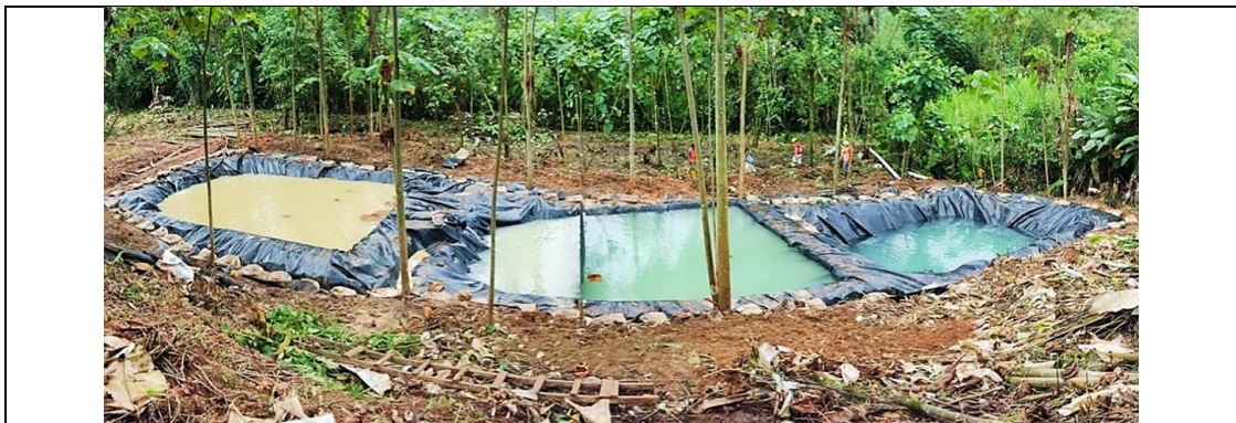
Fotografía 1.62. Panorámica Sistema de Tratamiento
