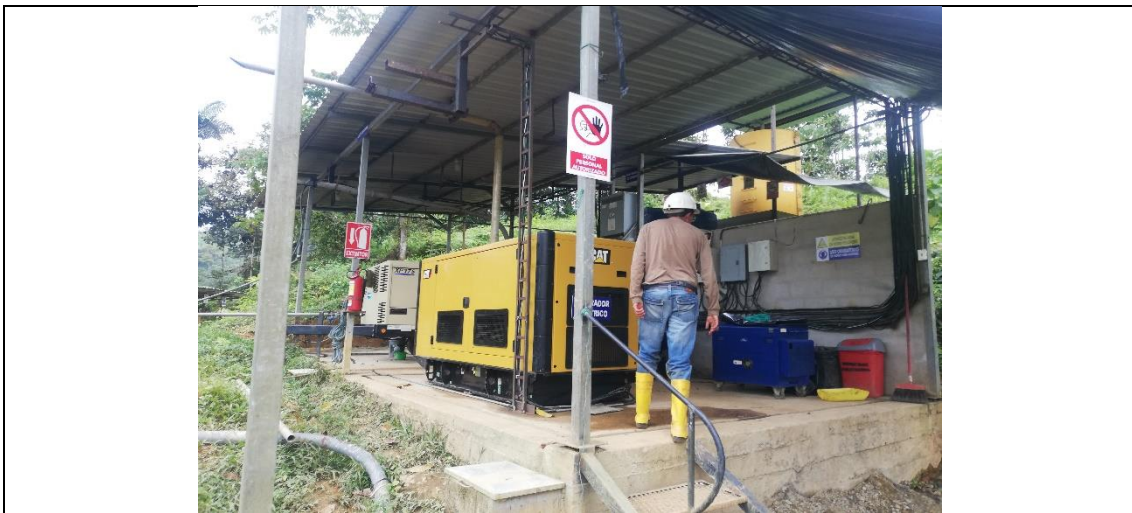
Fotografía 1.34. Generadores y compresores, Concesión minera Leliatere
