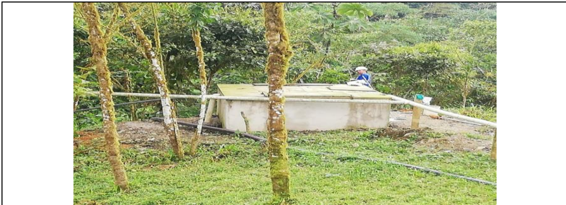
Fotografía 1.37. Pozo séptico, Concesión minera Leliatere
